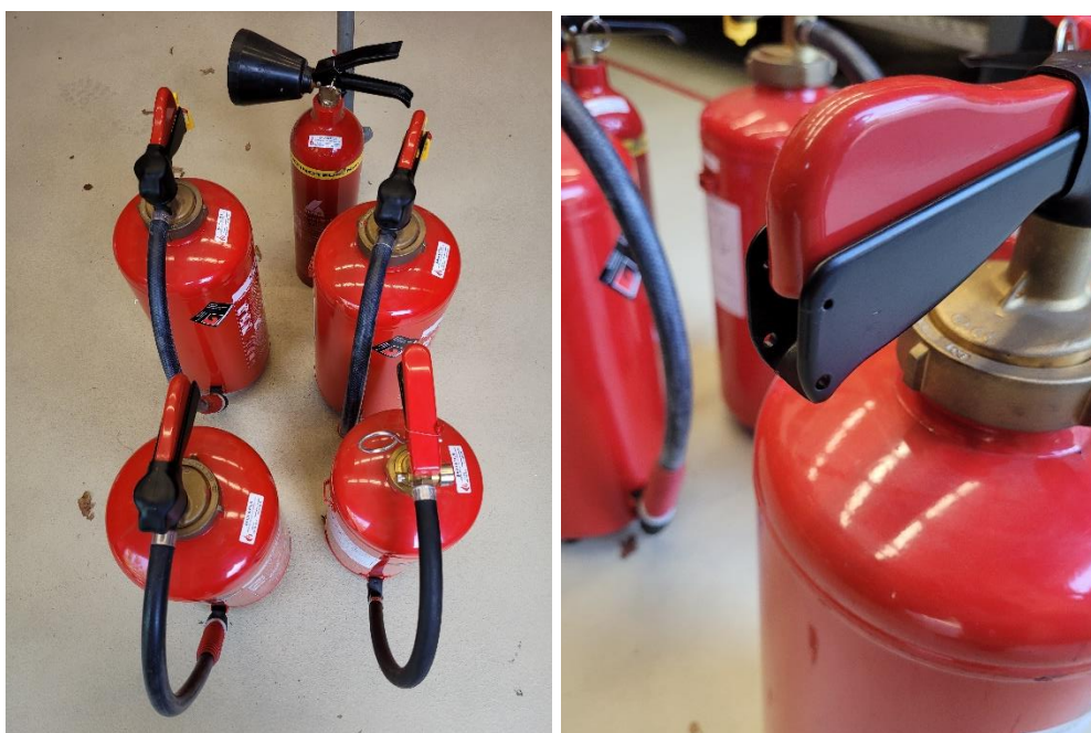
Les extincteurs retrouvés
